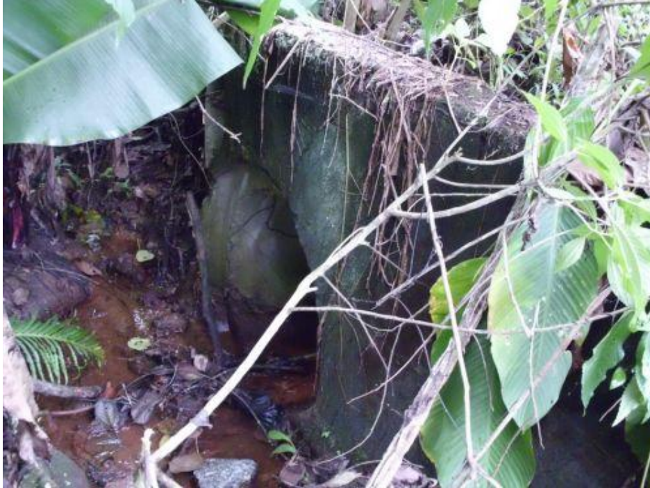
Foto 2-29: Passagem 2 composta por 1 tubo
