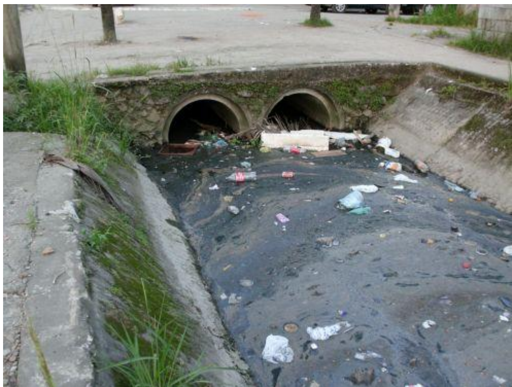
Foto 2-40: Passagem composta por 2 tubos de concreto Ø0,80 m no canal da Av. Antenor Pimentel
