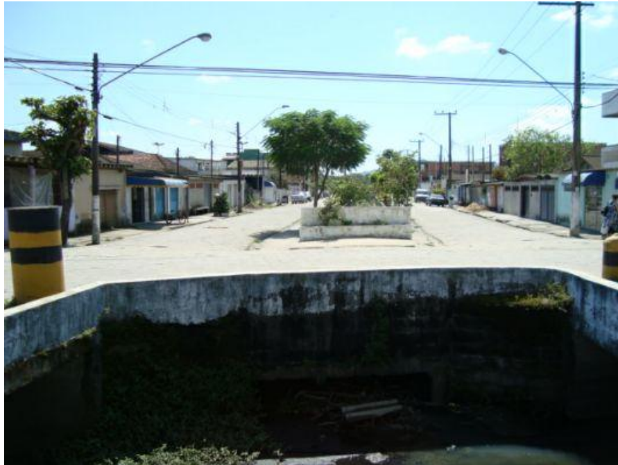
Foto 2-17: Saída em aduela dupla do canal da Av. Adriano Dias dos Santos com vista para montante.
