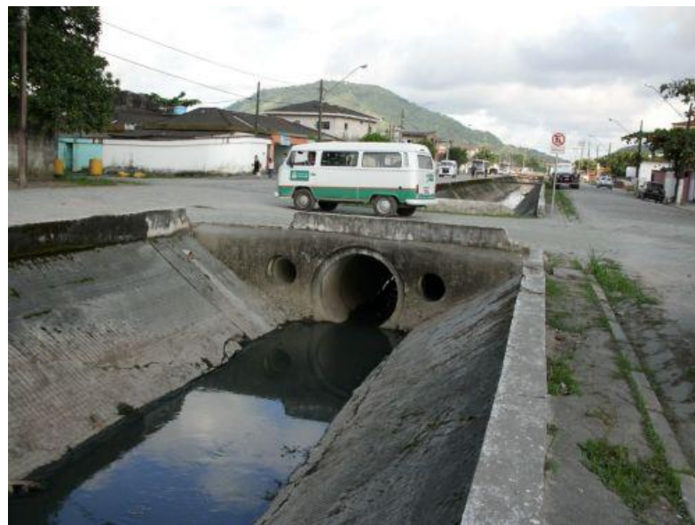
Foto 2-12: Passagem em tubo de concreto com tubo Ø1,50 m na Av. Mario Daige com a Rua Manoel Marques Naberto
